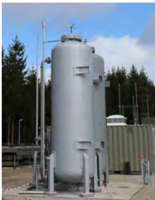
Foto nr. 03. Deodoriseringsanlæg.
