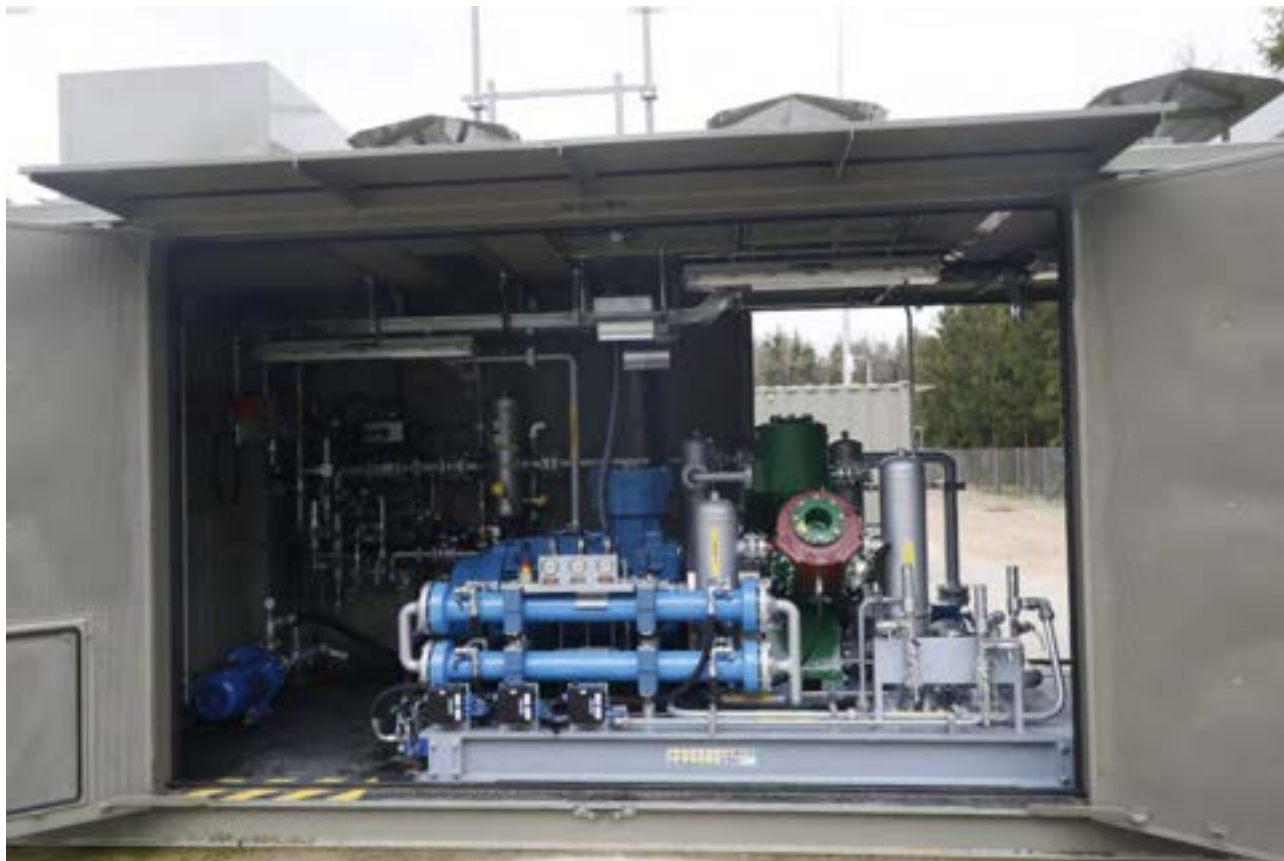
Foto nr. 01. Kompressor container med åbenstående kompressor rum.
